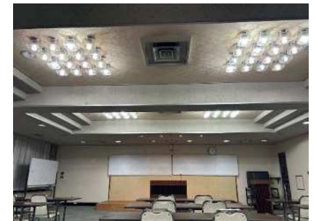
館内照明LED化
