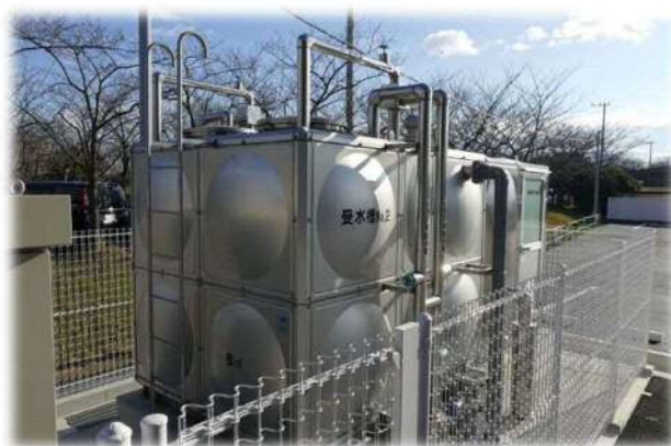
貯水槽水道（受水槽）
