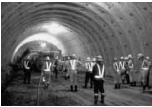
▲工事が進む生鼻崎第二トンネル(仮称)の全長は723㍍。生鼻崎トンネルの約2倍の長さです。
