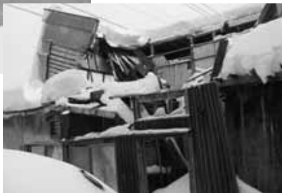
▲雪の重みで屋根の一部が剝壊する被害などがあり、改めて雪の恐ろしさを実感しました。
