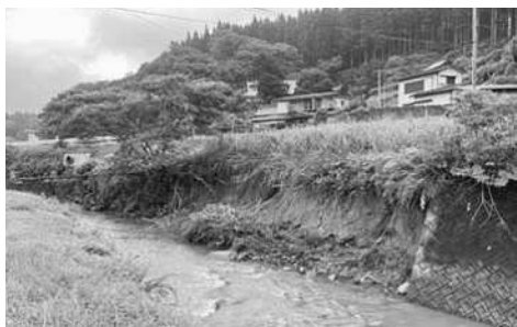
▲滝川川護岸崩落（男鹿中地区）
