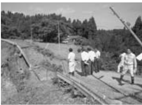
災害箇所での現地調査を行いました
