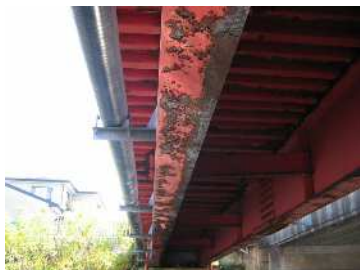
「防食機能が劣化した状態」
