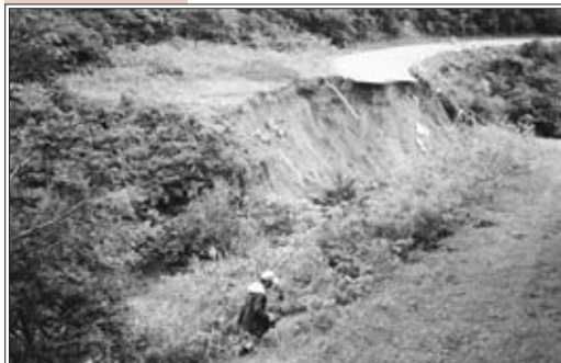
▲台風19号により甚大な被害 (写真：大棧橋有料道路が崩落)
